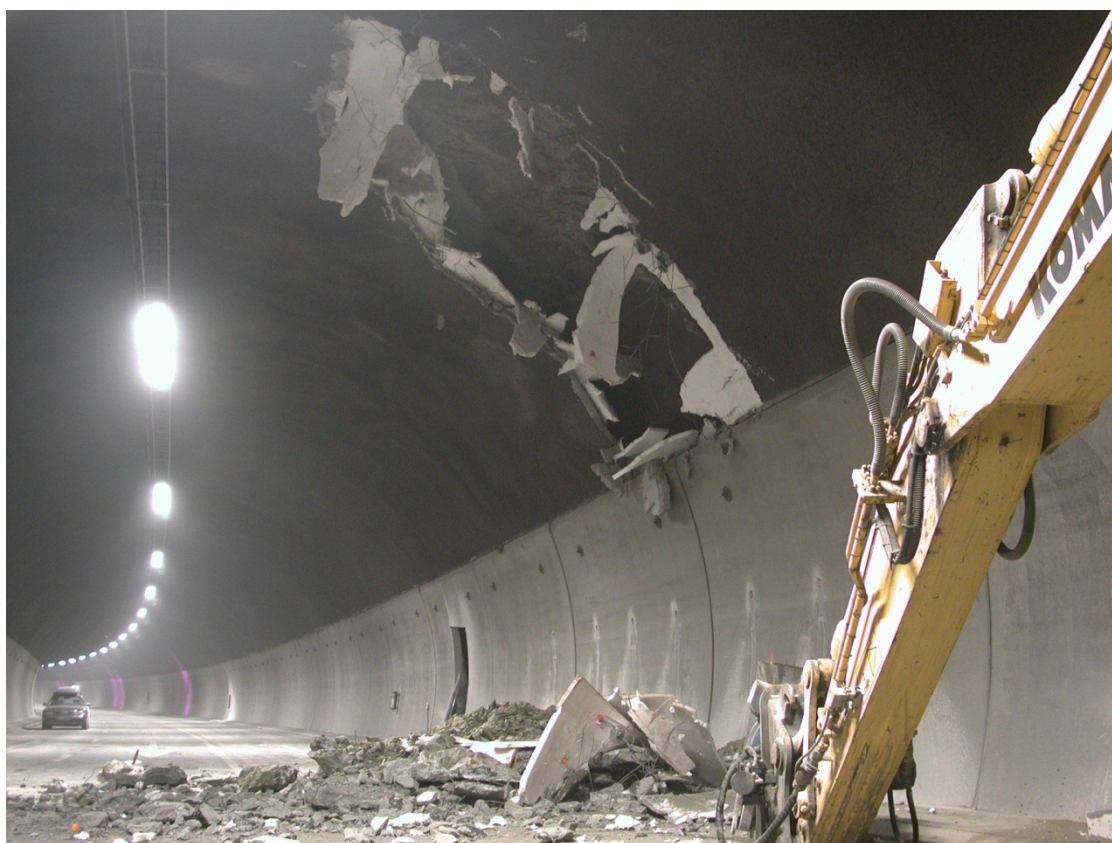
Figur 4. Ras i berget bakom inklädnad med PE-skum och sprutbetong, så kallad Vatten- och Frostisolering. Raset inträffade 2003, 3 år efter att tunneln var klar. 2004 gjordes inspektion bakom inklädnaden då flera mindre ras påträffades. Tunneln fick återigen stängas för reparationsarbeten.
