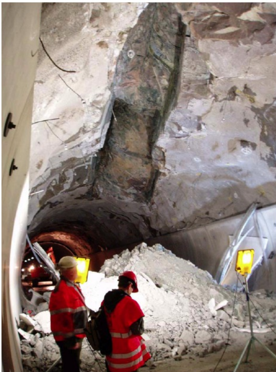
Figur 5. Raset i en sprickzon i taket på Hanekleiva tunneln.
